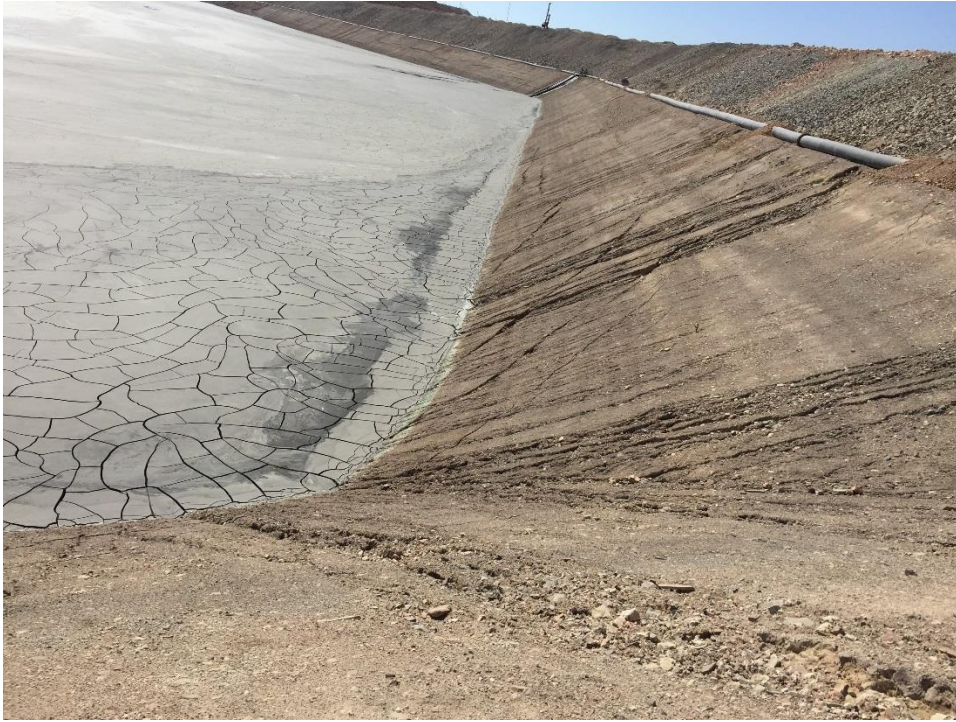
Fotografía 21: Muro Nororientado – Agrietamientos Diagonales Estribo Sur
