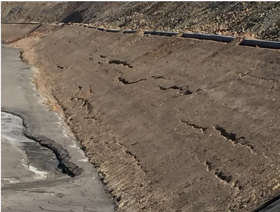
Fotografía 24: MNO – Agrietamientos Horizontales Talud Aguas Arriba Estribo Sur
