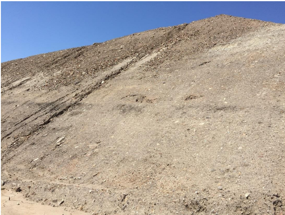
Fotografía 32: BS – Cárcavas por Escorrentía Superficial
