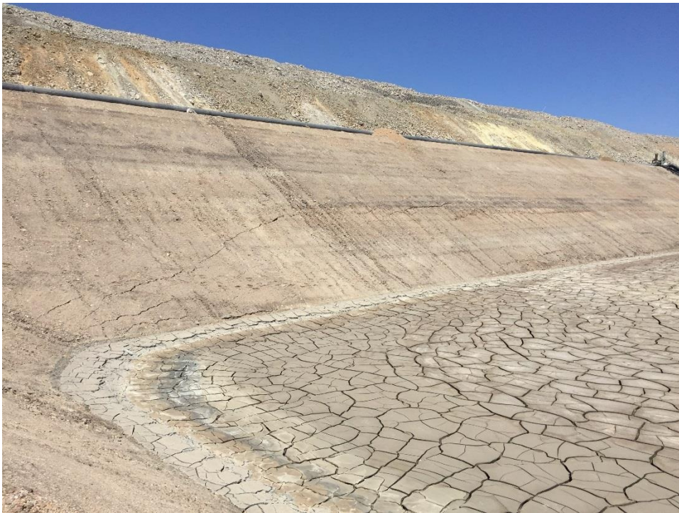
Fotografía 30: MO – Estribo Norte – Agrietamiento Talud Aguas Arriba
