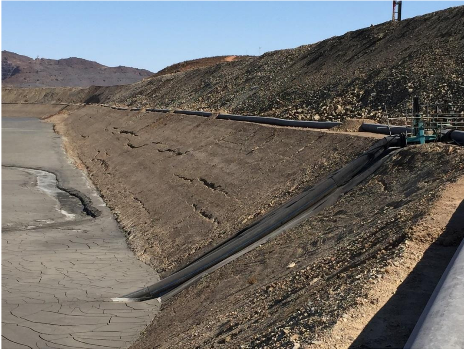
Fotografía 23: Muro Nororientado – Vista hacia el Norte - Agrietamientos Horizontales
