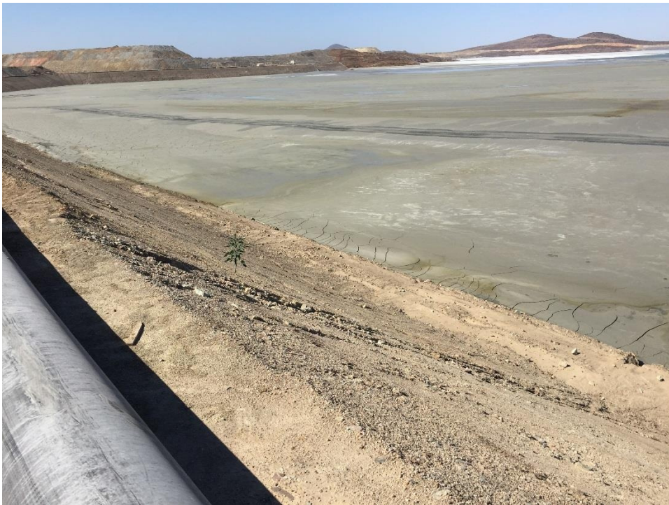
Fotografía 26: MNO – Erosion por Escorrentía Superficial y Arbusto en Talud Aguas Arriba
