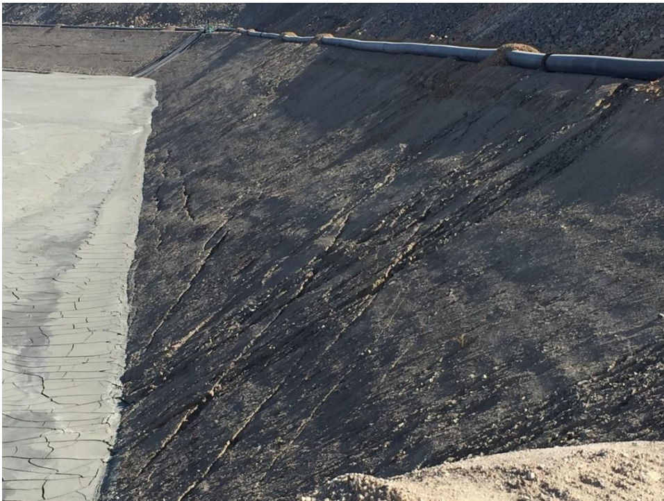
Fotografía 20: Muro Nororientado – Agrietamientos Diagonales Estribo Sur
