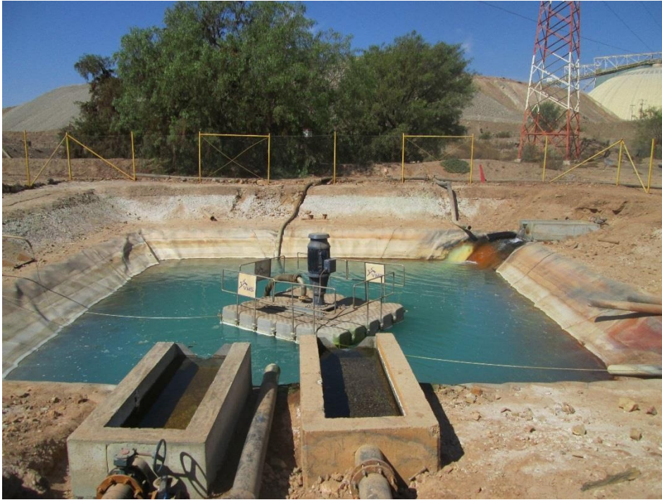
Fotografía 43: MNO – Piscina Colectora de Filtraciones Aguas Abajo y Aforador
