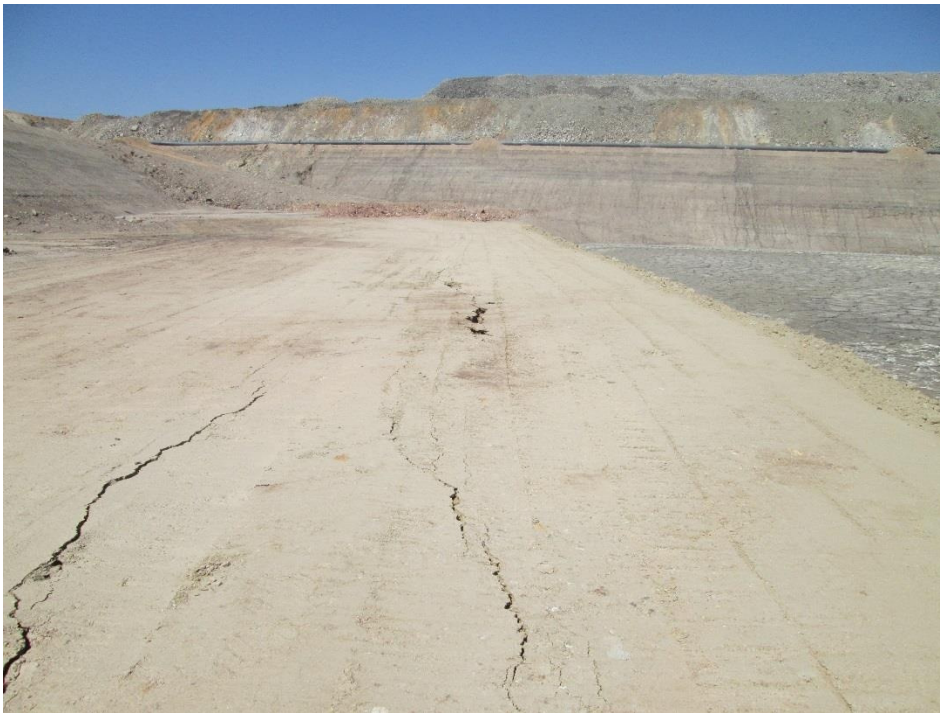
Fotografía 34: BS – Agrietamientos Pl. 1.141 msnm
