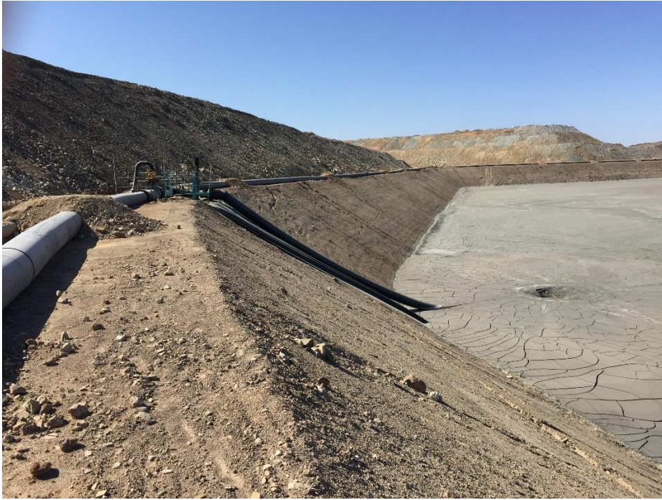
Fotografía 25: MNO – Vista hacia el Sur - Agrietamientos Horizontales Talud Aguas Arriba
