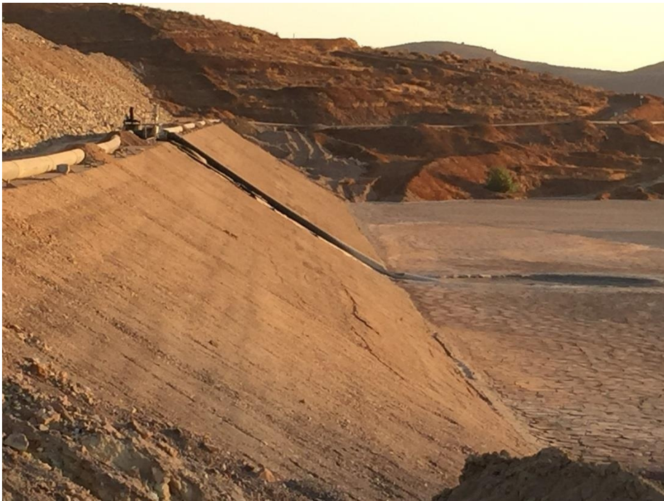
Fotografía 18: Muro Oriente –Vista hacia el Sur – Agrietamientos
