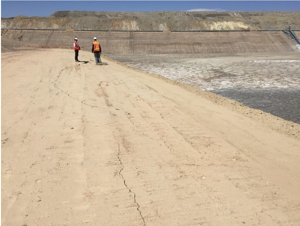
Fotografía 31: BS – Agrietamientos Pl. 1.141 msnm
