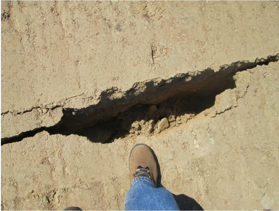
Fotografía 35: BS – Agrietamiento Pl. 1.141 msnm
