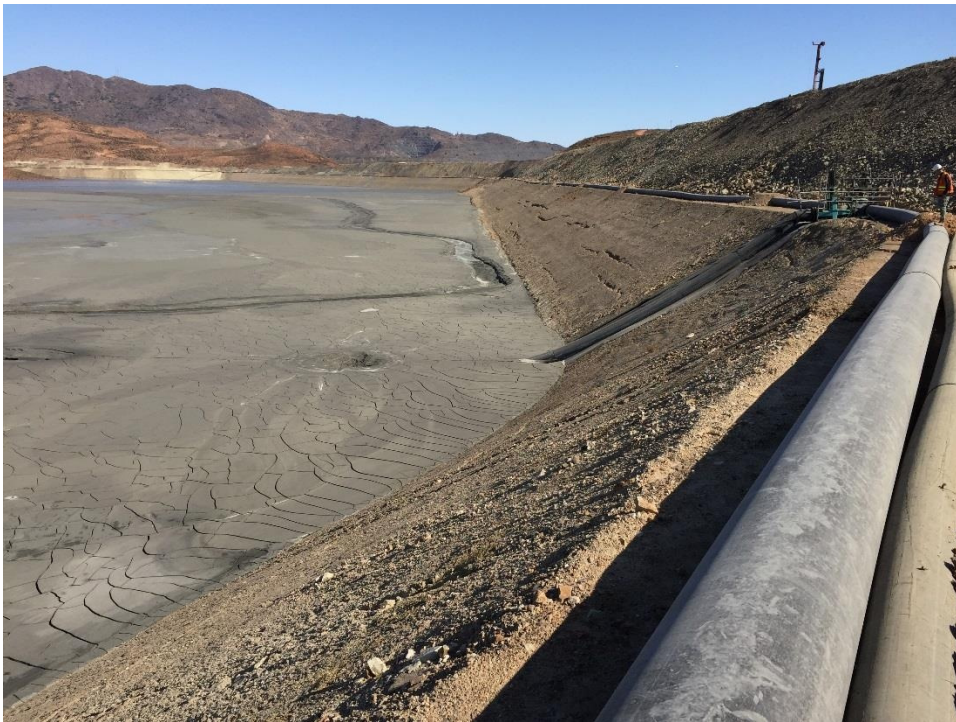
Fotografía 22: Muro Nororientado – Vista hacia el Norte - Agrietamientos Horizontales
