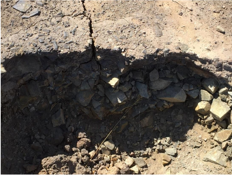
Fotografía 29: MN - Calicata Agrietamiento Relleno Masivo El. 1.162 msnm
