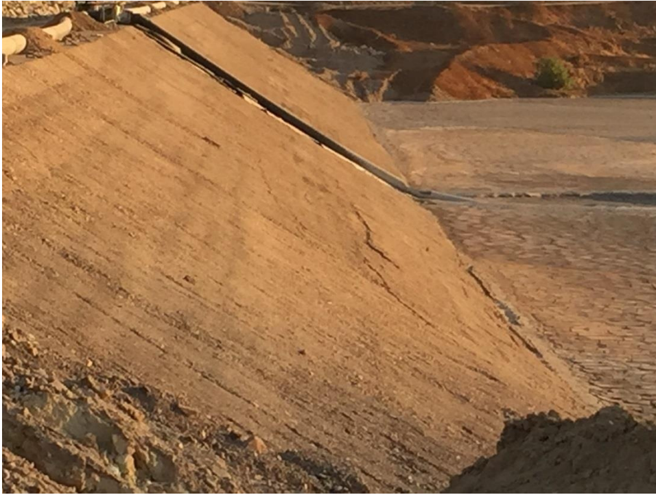
Fotografía 17: Muro Oriente –Vista hacia el Sur – Agrietamientos
