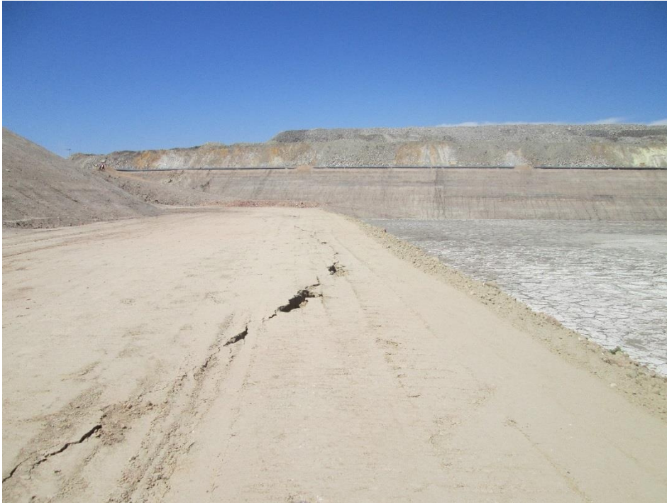
Fotografía 33: BS – Agrietamiento Pl. 1.141 msnm
