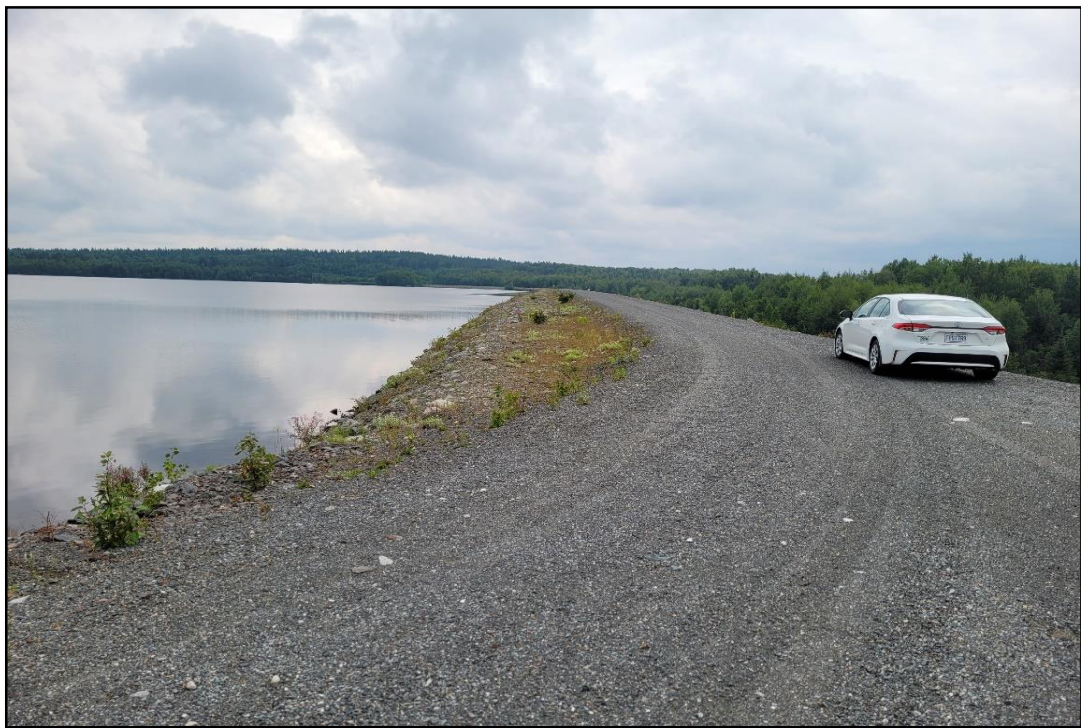
Photo 2 : Digue 1C – Vue de la pente amont avec enrochement abimé,
