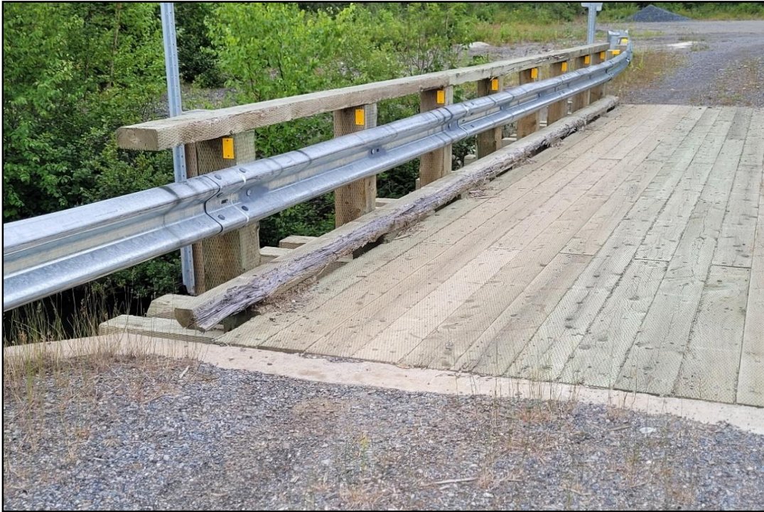
Photo 5 : Pont d'accès au site avec protection de voie quelque peu abimée, mais toujours utilisable.
