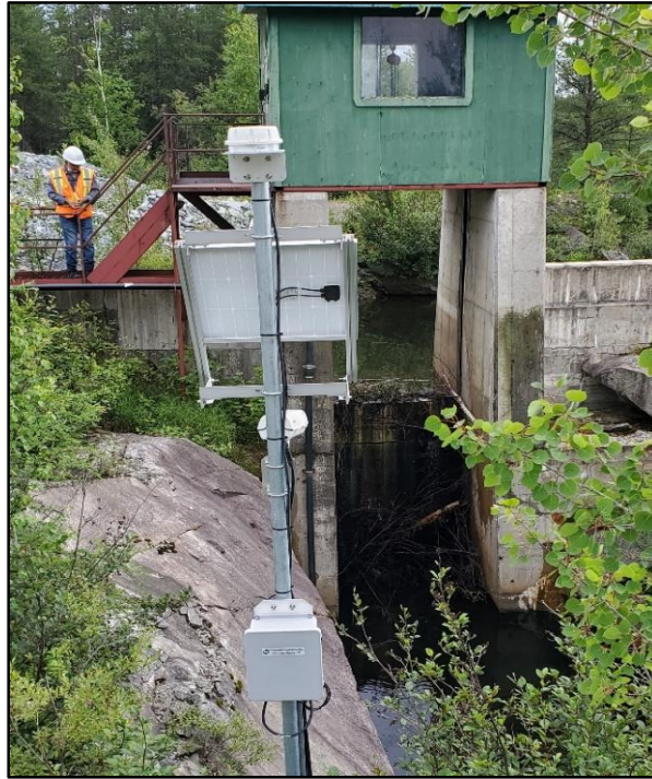
Photo 13 : Digue 4B – Vue aval du déversoir. Faible exfiltration d'eau au contact du béton et du roc.
