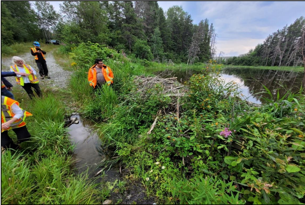
Photo 15 : Pied de la digue 4B. Construction importante de barrage de castors.
