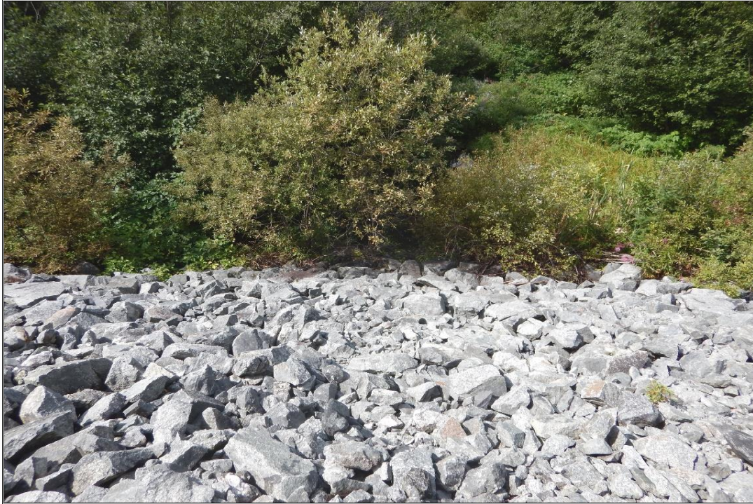
Photo 9 : Digue 2B – Vue de l’accumulation d’eau au pied de la digue, essentiellement inchangée depuis 2020.
