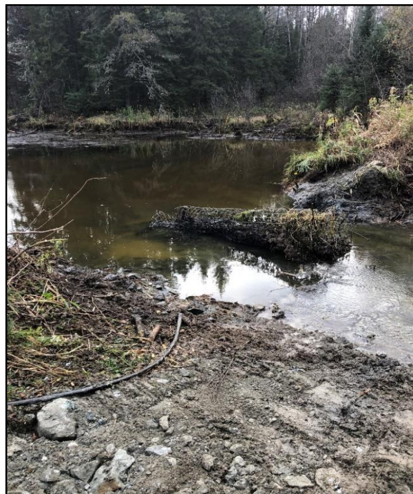
Photo 16 : Pied de la digue 4B. Même endroit que la photo 15, montrant l'enlèvement ponctuel du barrage de castors.
